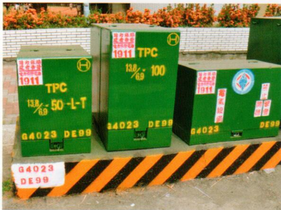
照片六 變電箱上9碼的電力座標
