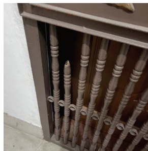
圖6、剪斷大門欄杆方式侵入
