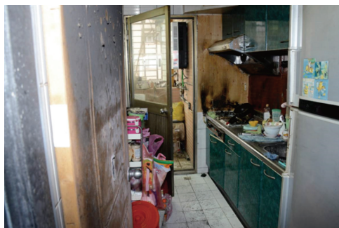
圖7、廚房起火位置
