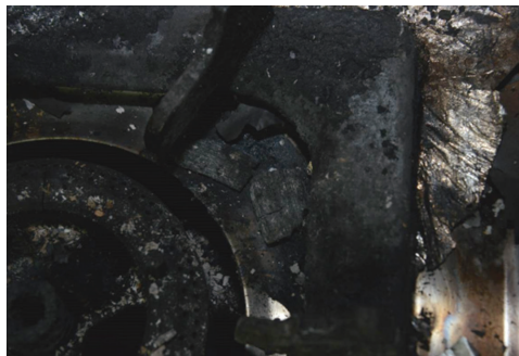
圖13、瓦斯爐周圍排油煙機罩殘骸
