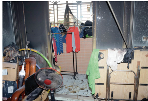
圖2、陽臺受燒情形
