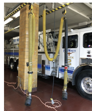
分隊車庫內連接消防車輛排氣管抽氣管線
